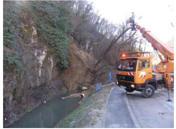
Slika 10 Klizište u ulici Sutinska Vrela. Hitne mjere sanacije
