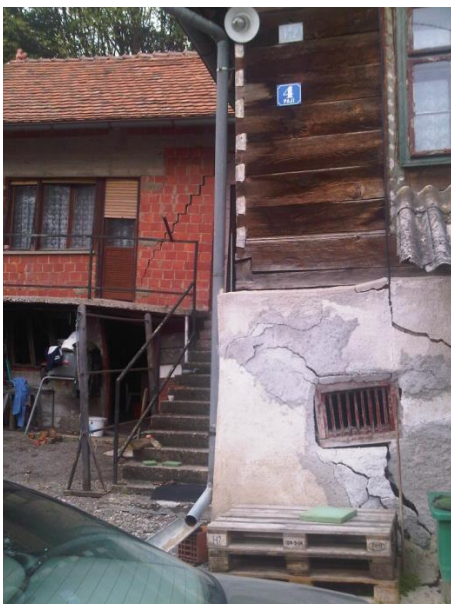
Slika 9. Oštećenja na objektima izgrađenim na klizištu u Glavnici Gornjoj
